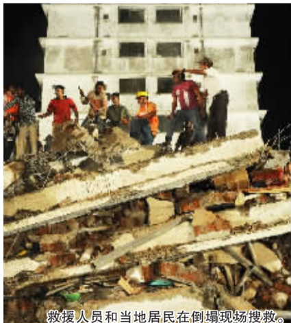
救援人员和当地居民在倒塌现场搜救。
