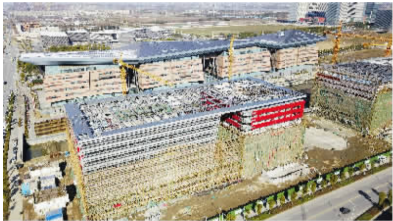
省运会体操项目比赛场馆——广陵体操馆建设工程进展顺利,目前土建施工和钢结构施工已全部完成,进入内外装饰装修阶段,从空中鸟瞰,整个场馆初露真容,预计今年5月底试运营。
