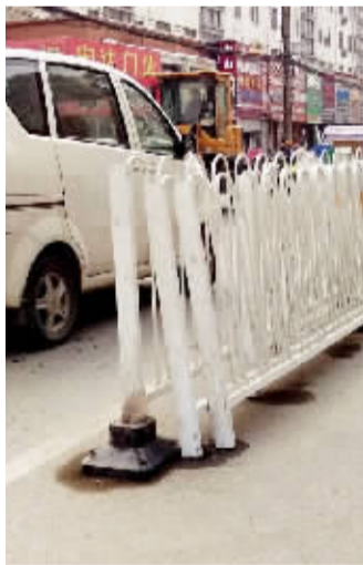
在市区施井路,几处交通护栏被人为拆除。
